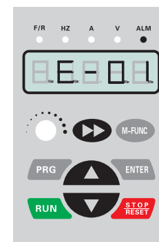
图1-5 加速中过流故障报警显示
